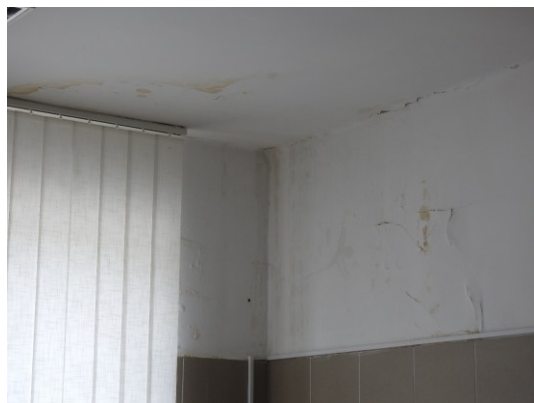
4. kép: Beázás nyomai az Egészségházban (Szabolcs Vezér út 11.)
